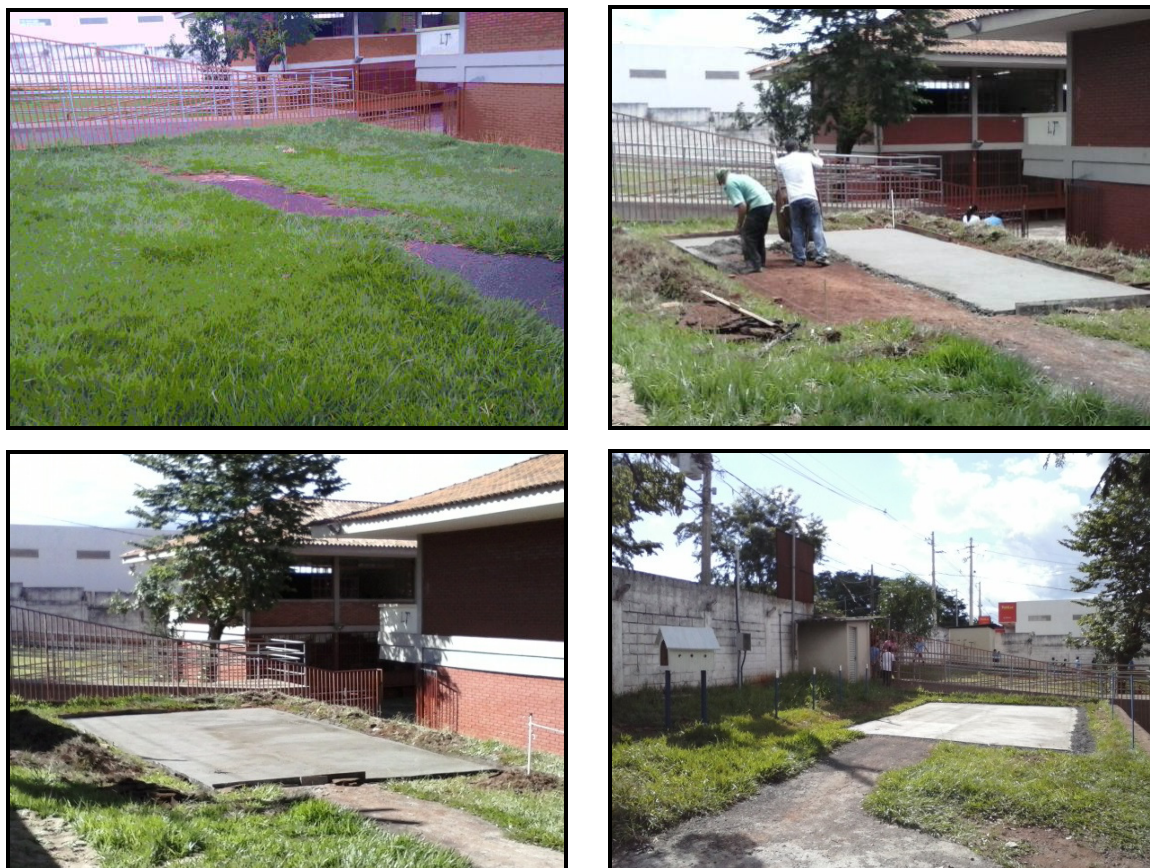
Figura 01: À esquerda superior, o espaço disponível, à direita superior, a construção do OLHE; na parte esquerda inferior, o término da construção da base do OLHE; à direita inferior início da instalação dos instrumentos meteorológicos.
